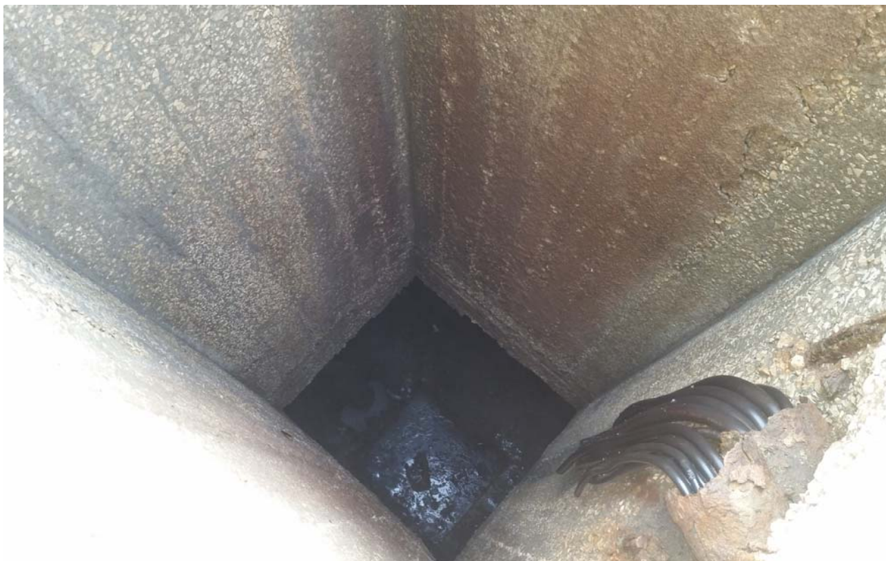
Fotografia 03 – Vasca alloggiamento elettropompe
