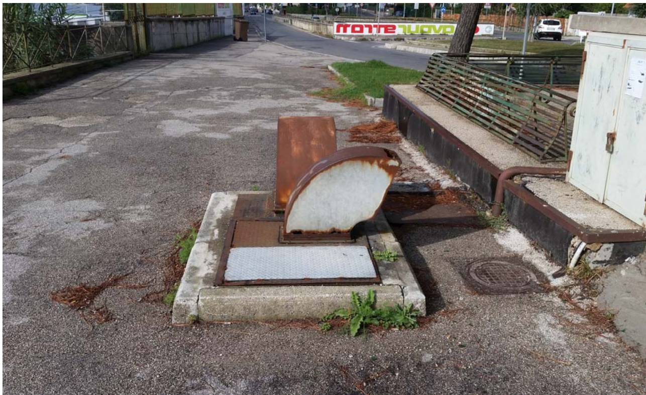
Fotografia 04 – Vista esterna del gruppo elettrogeno
